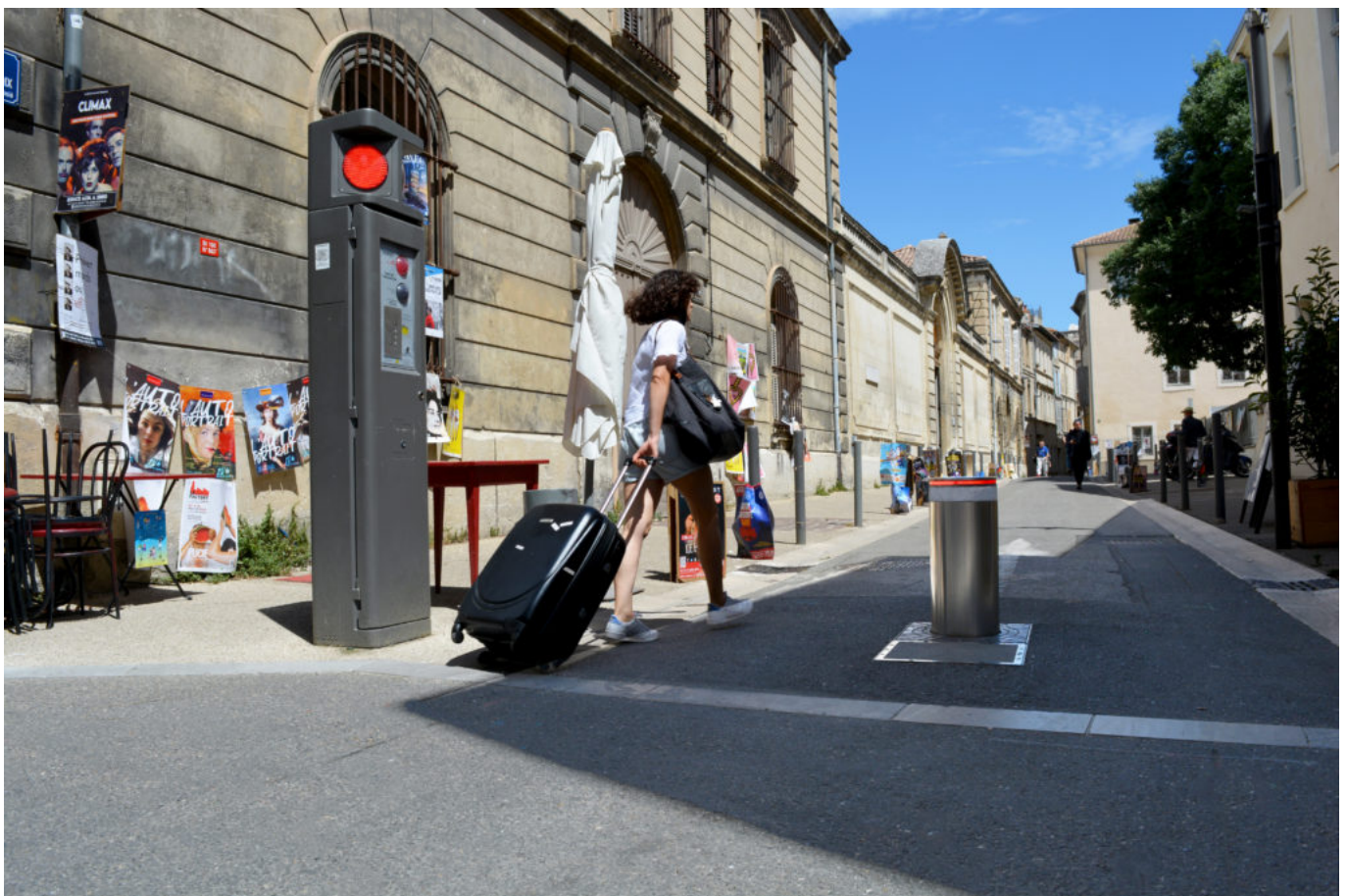
Système BES installé à Avignon
