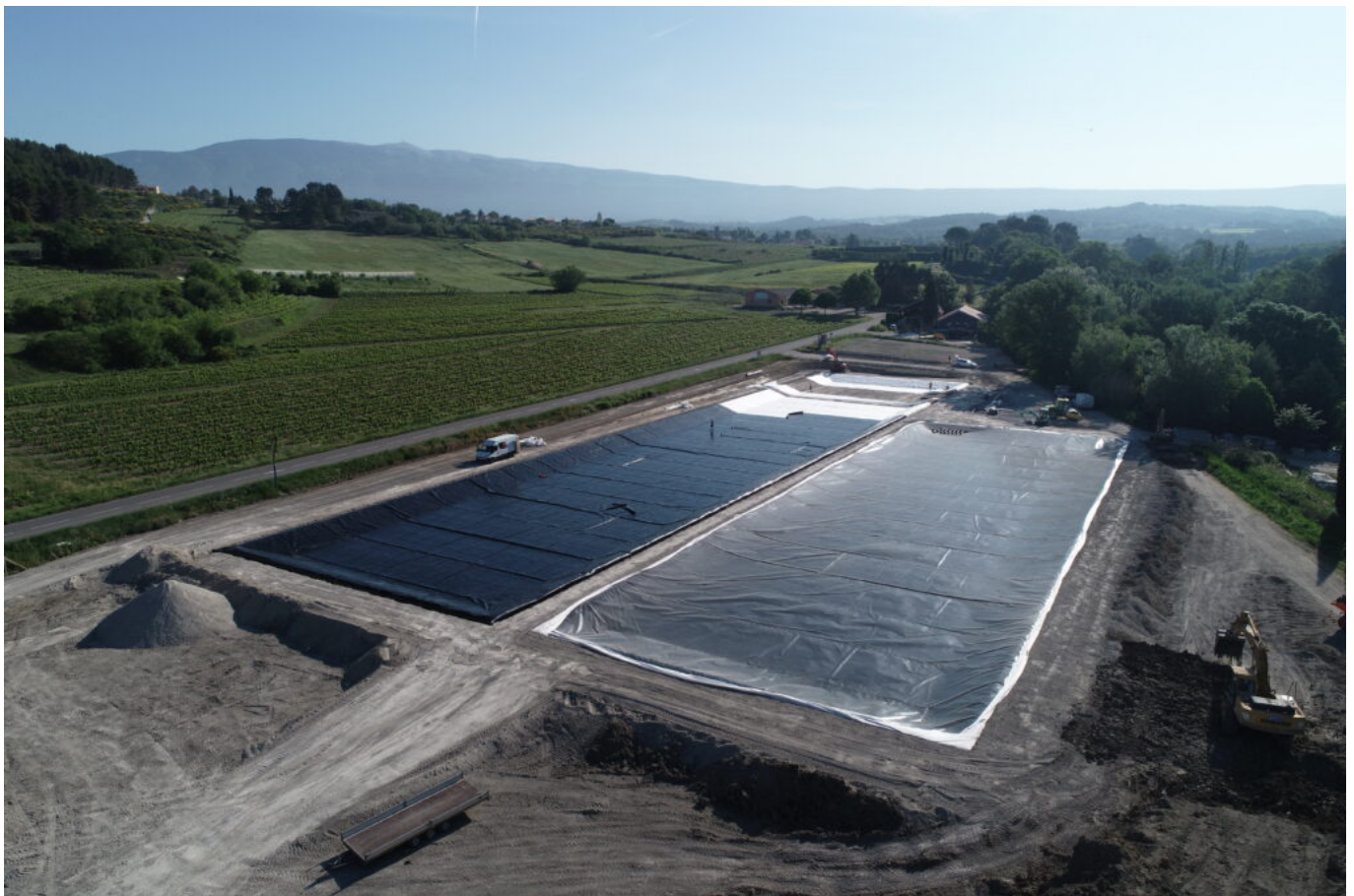
La station d'épuration des eaux usées lors des travaux avant qu'elle ne soit finalisée
