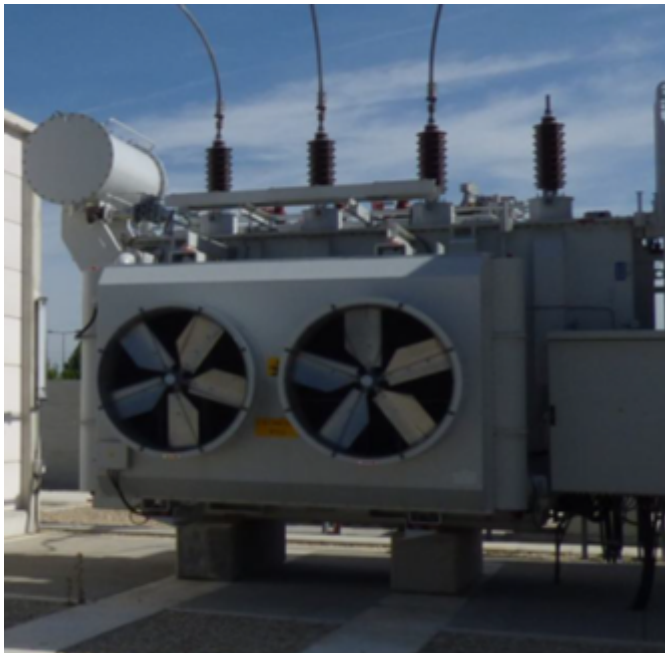
Un des deux transformateurs rénovés © DR
