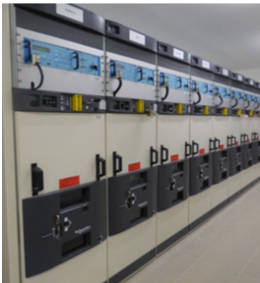
Les disjoncteurs ont été modernisés avec la mise en place de protections © DR
