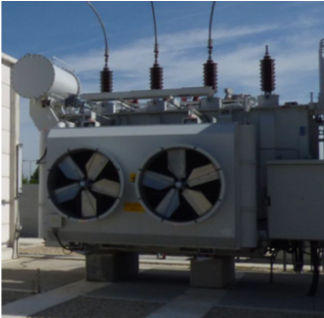
Un des deux transformateurs rénovés © DR
