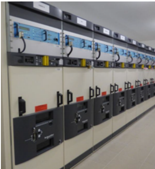
Les disjoncteurs ont été modernisés avec la mise en place de protections © DR
