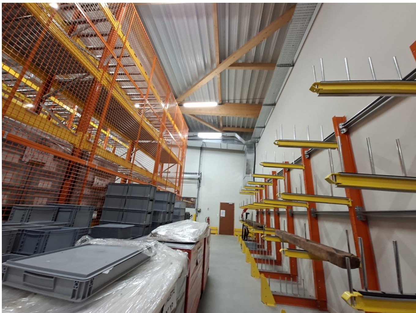
Les galeries de 6m de haut qui abriteront les trésors du patrimoine de Vaucluse
