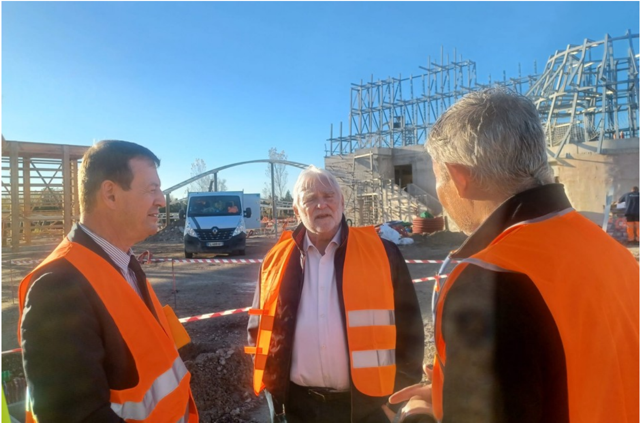
Christian Gros avec le préfet de Vaucluse sur le chantier de Naruto au parc Spirou. Crédit : DR
