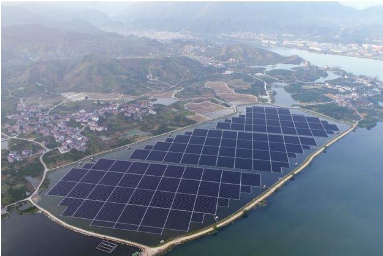
Centrale solaire flottante de Piolenc. DR
