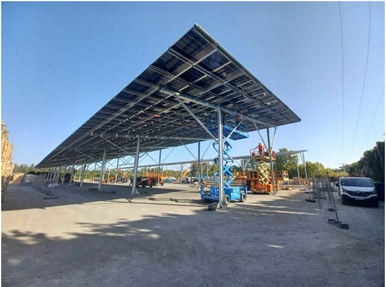
Chantier sur les zones de stockage de Natural Rock Distribution à Avignon. ©Melvan
