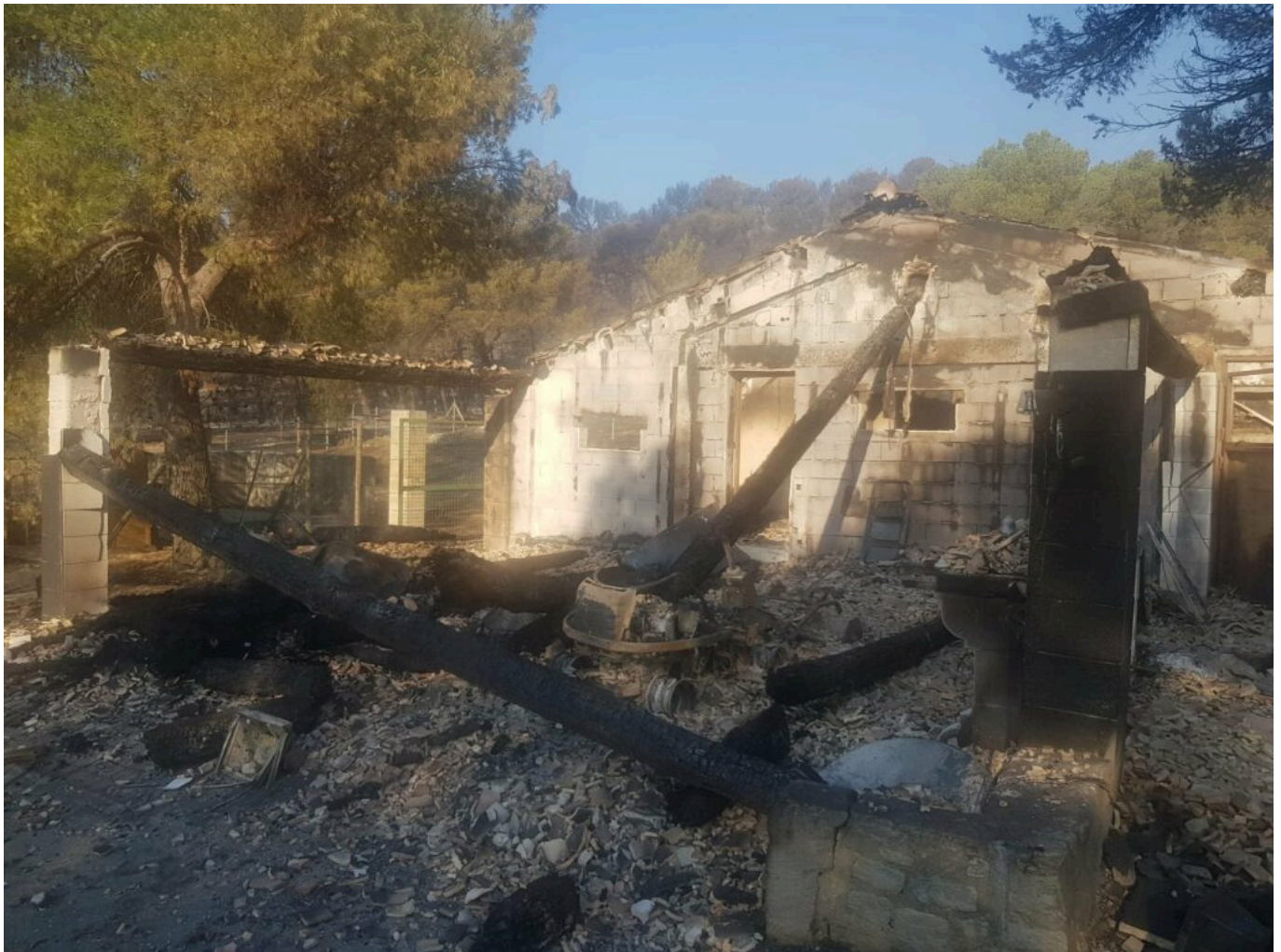
Dégâts constatés par la commune de Barbentane. © Commune de Barbentane
