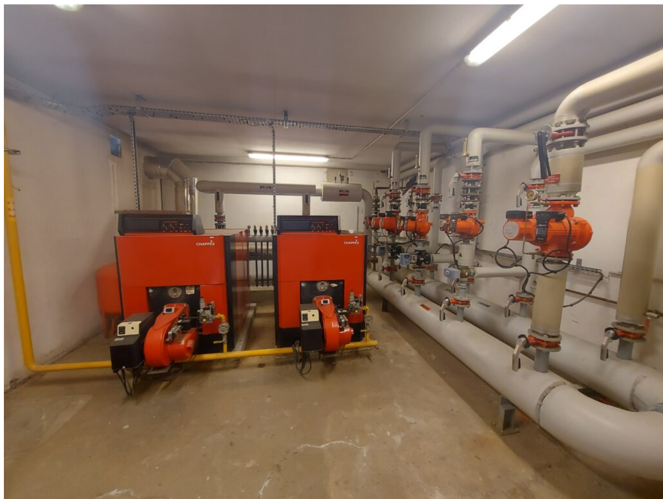
Chaufferie collège A Silve Copyright Département de Vaucluse communication
