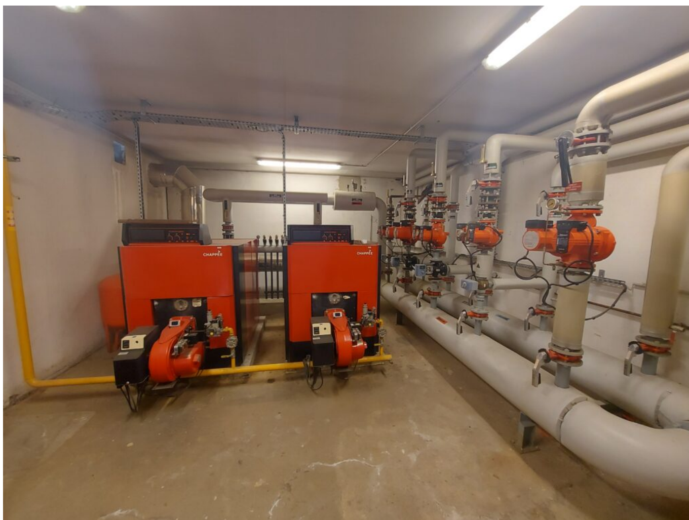
Chaufferie collèe A Silve Copyright Département de Vaucluse communication
