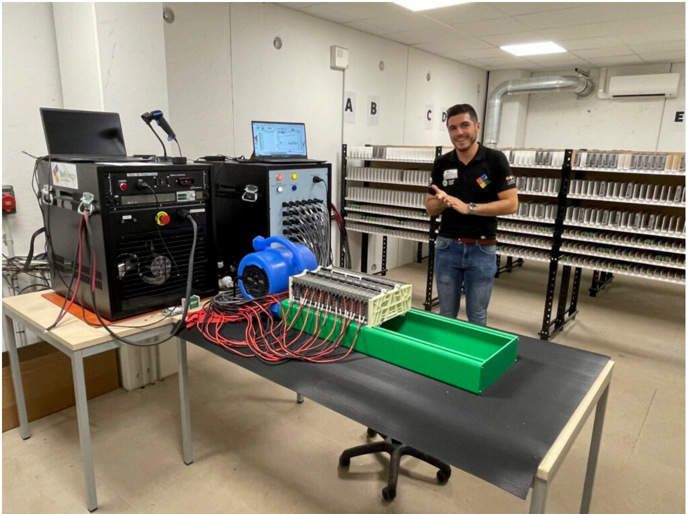
Test de batteries
