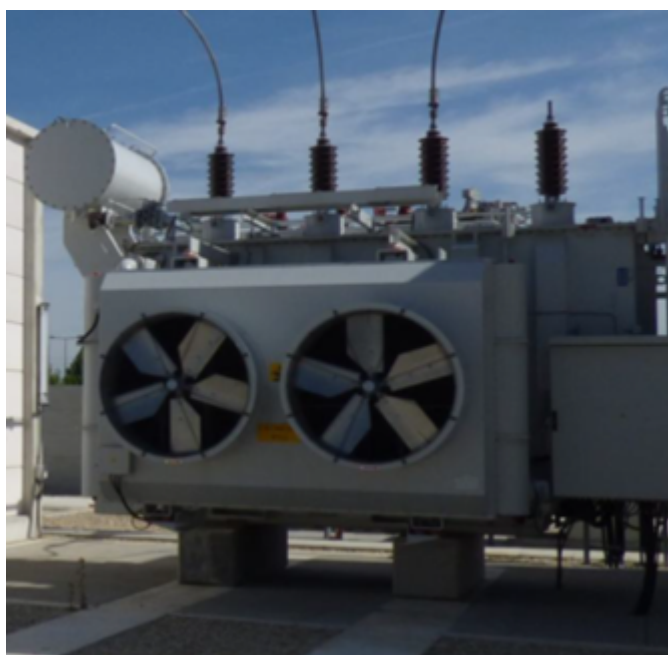
Un des deux transformateurs rénovés © DR
